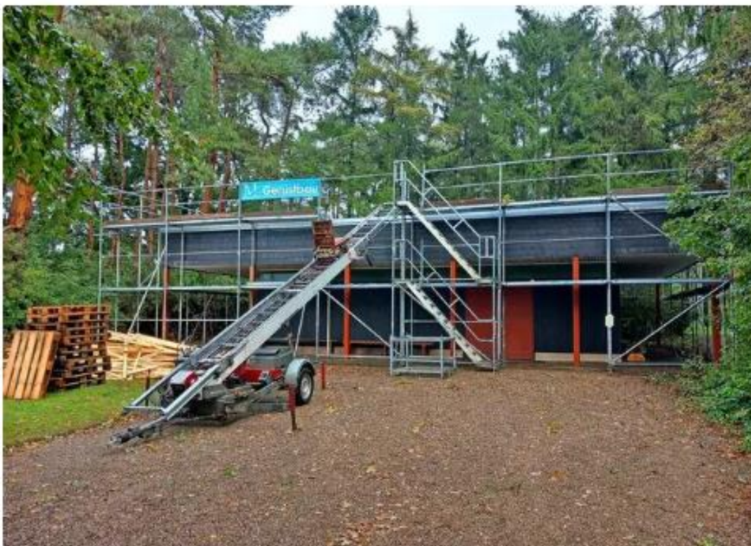
Noch eingerüstet: Ab Anfang November kann die Friedhofskapelle wieder genutzt werden. © Quelle: Friedrich Bernstorf
