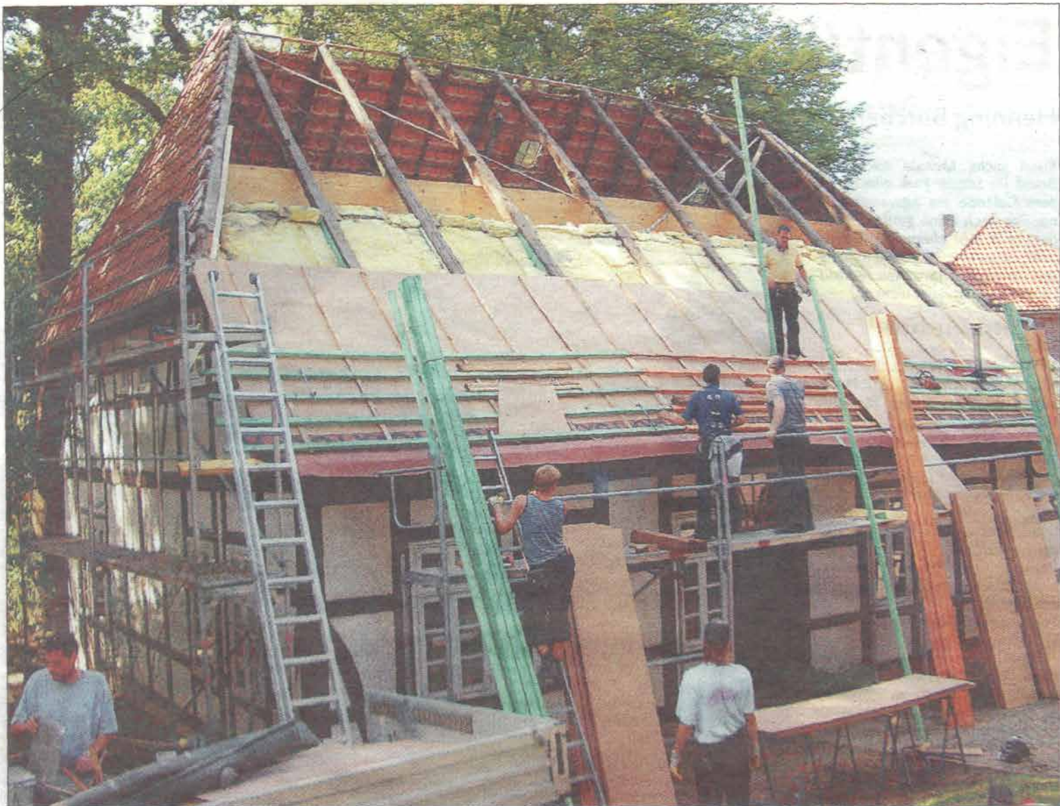
Seit gestern erneuern Dachdecker die Ostseite des über 200 Jahre alten Fachwerkhouses, in dem der Kirchenkreisjugenddienst seinen Sitz hat. Bernstorff
